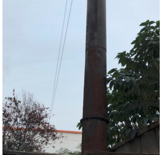
锅炉废气排气筒
