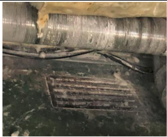
织布车间内地面抽风口
