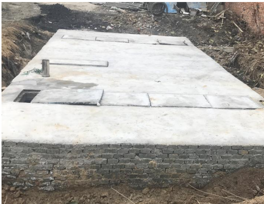
浆纱废水三级沉淀池
