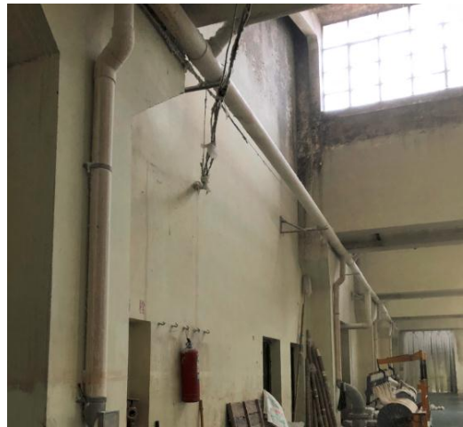
车间地面吸尘管道
